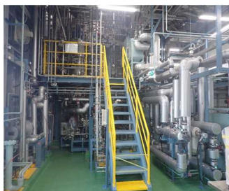
ポリマー合成開発設備
