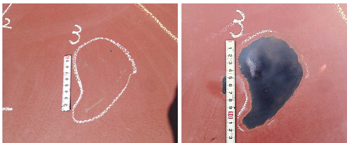
図 2.1.1.1-22 塗装を剥離する前の損傷状況と塗装剥離後の母材損傷状況
