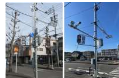
図 AI交通信号機の設置状況
