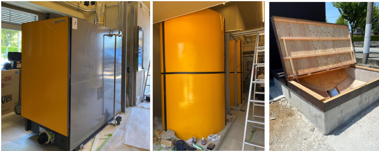
図5 交流施設バイオマスボイラ
