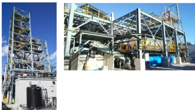
写真 実証試験設備 左：CO 2 分離・回収設備、右：炭酸化反応装置（外熱式ロータリーキルン）
