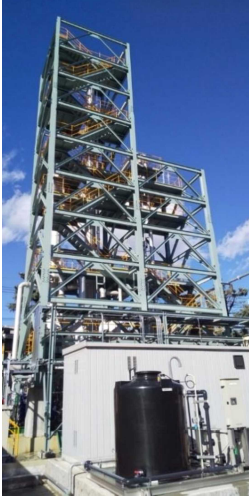
CO 2 分離・回収設備
