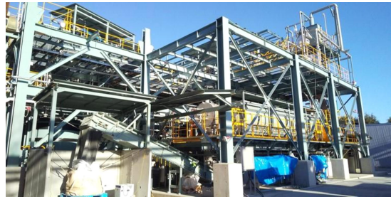
CO 2 有効利用設備
