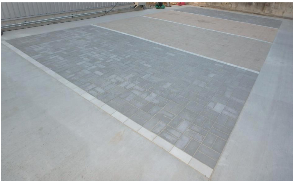
敷設したインターロッキングブロック (手前から普通ブロック市販品、普通ブロック実証製造品、 透水ブロック実証製造品、透水ブロック市販品)
