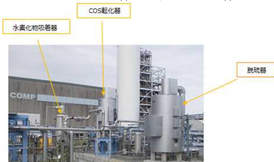
図 3-2-2-29 燃料電池用ガス精製設備
