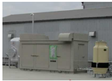
都市ガス圧縮機
