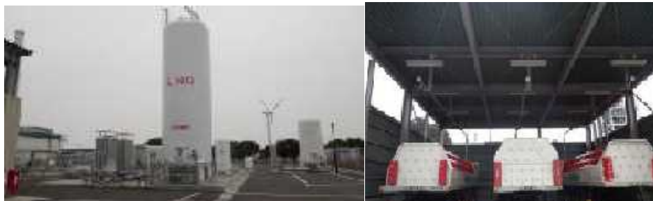
(a)LNG/N 2 供給設備
