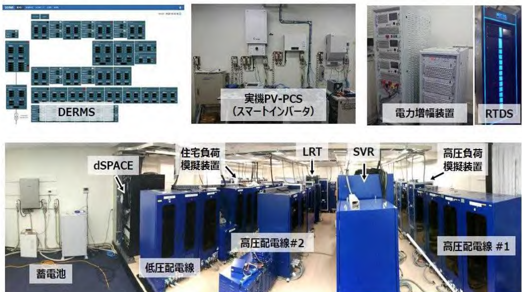
配電系統アナログシミュレータ : ANSWER (Active Network System with Energy Resources)
