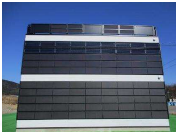
ビル壁面に設置例
