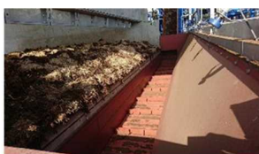
原料投入エプロンコンベア
