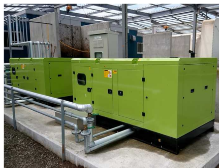
50kW発電機(中国) ～原料受入棟に電力／温水供給(受入槽加温、ロードヒーティング)
