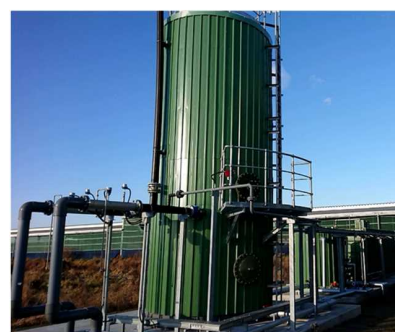
生物脱硫装置(中国) ～バイオガス中の硫化水素除去
