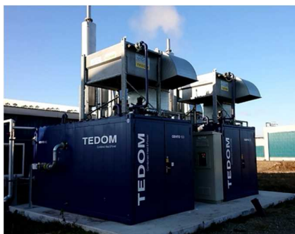
100kW発電機(チェコ) ～BGP、酪農家に電力／温水供給
