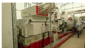
ORC熱電併給設備
