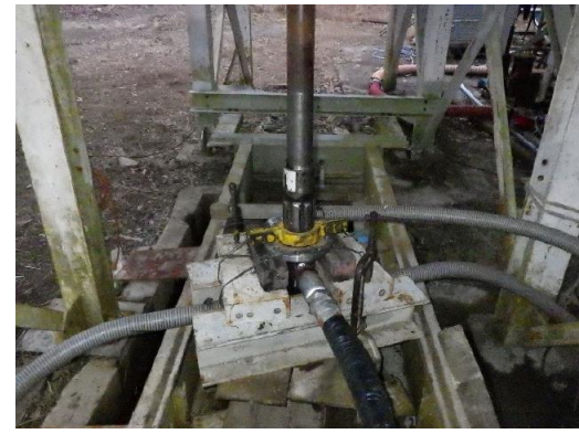
抗口の配管状況
