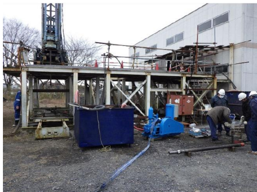
試験設備全景
