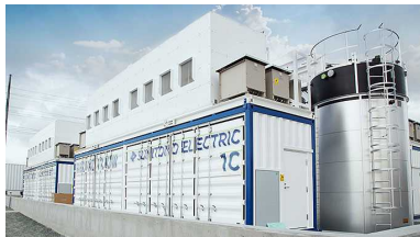
設置されたレドックスフロー電池
