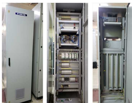
転炉設備DCS
