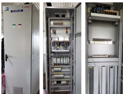
COB設備DCS
