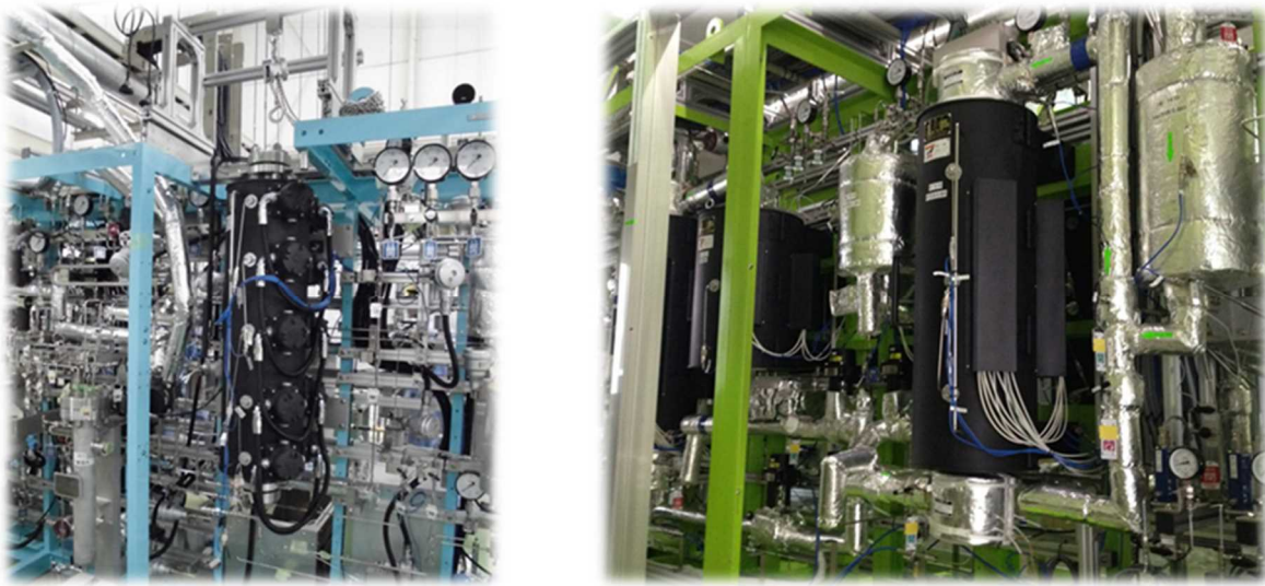
図Ⅲ. 2-2-1-2. 2016年度に検討した小型パイロットプラントの外観 (左：メタノール合成小型パイロット、右：MTO 小型パイロット)
