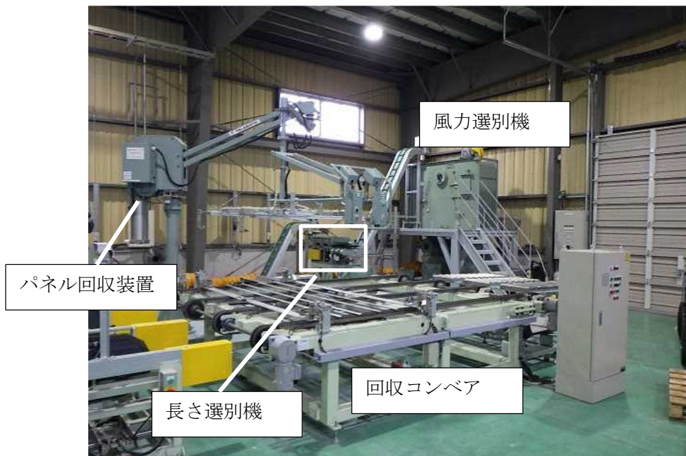
図Ⅲ-2-(ロ)-(ii)-A-7、回収コンベア、パネル回収装置、長さ選別機、風力選別機
