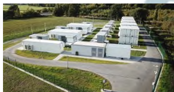
大規模ハイブリッド蓄電池システム実証（ドイツ）
