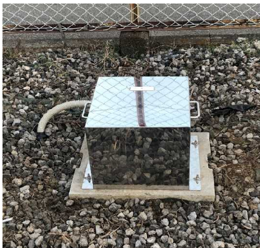
写真 3.2-1 地盤に設置した地震計
