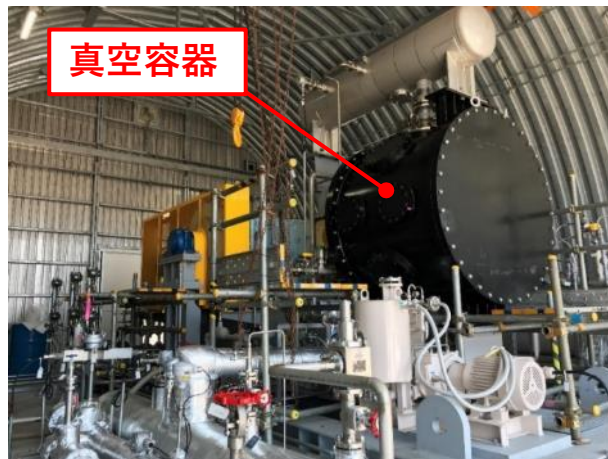
試作機外観（真空容器側）
