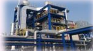
バイオマス燃焼炉・ボイラー
