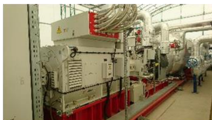
ORC熱電供給設備
