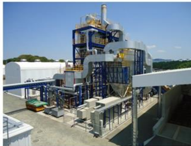
<バイオマス熱電併給設備全景>
