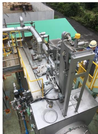
ボイラ外観 (手前: 燃焼ガス入り側)
