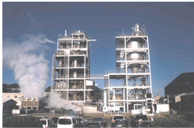
図 3.2.1.1-2 50TPD 石炭ガス化炉試験設備
