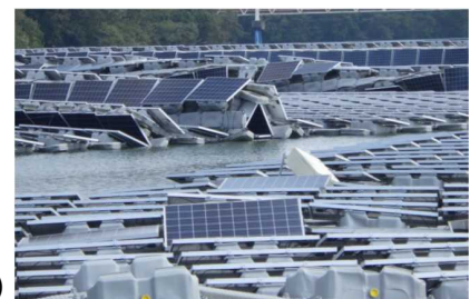
台風による被害(水上)
