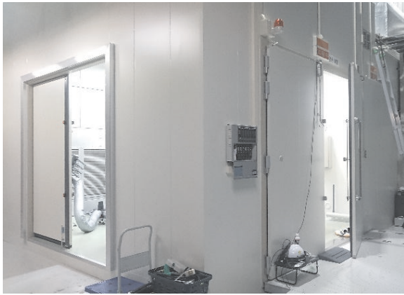
(1) 室外機室外観
