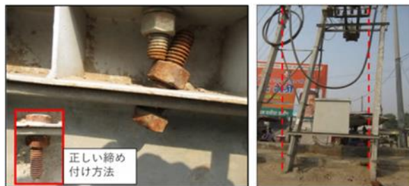
図 21:締め付け不良のボルト (左)、傾いた支柱 (右)
