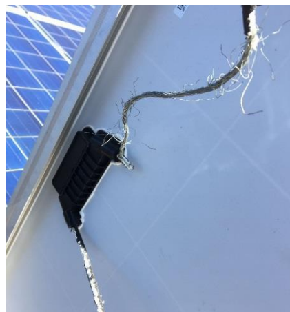
図12 小動物によるケーブル破損
