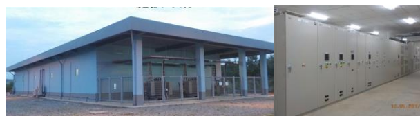
図4 HQPSを設置していた工業団地内の施設（外観・内部）
