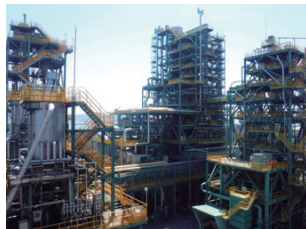
図28 ● フェロコークス300t/d 実証設備
