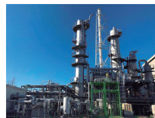
図26 ● 住友共同電力 新居浜西火力発電所(143t-CO 2 /日)
