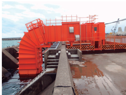
図16 ● 空気タービン式波力発電の外観
