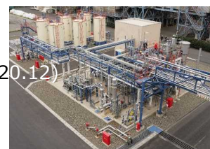
川崎脱水素プラント
