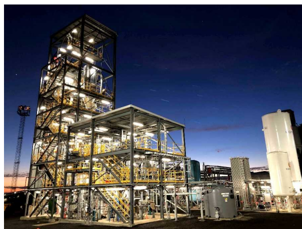
プラント全景 (2020.7.29撮影)
