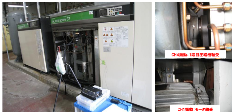
図 3-3.1.3-7 実食品工場内コンプレッサ測定
