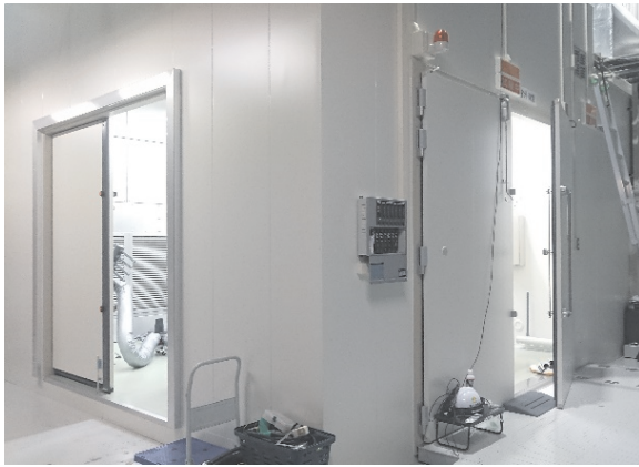
(1) 室外機室外観
