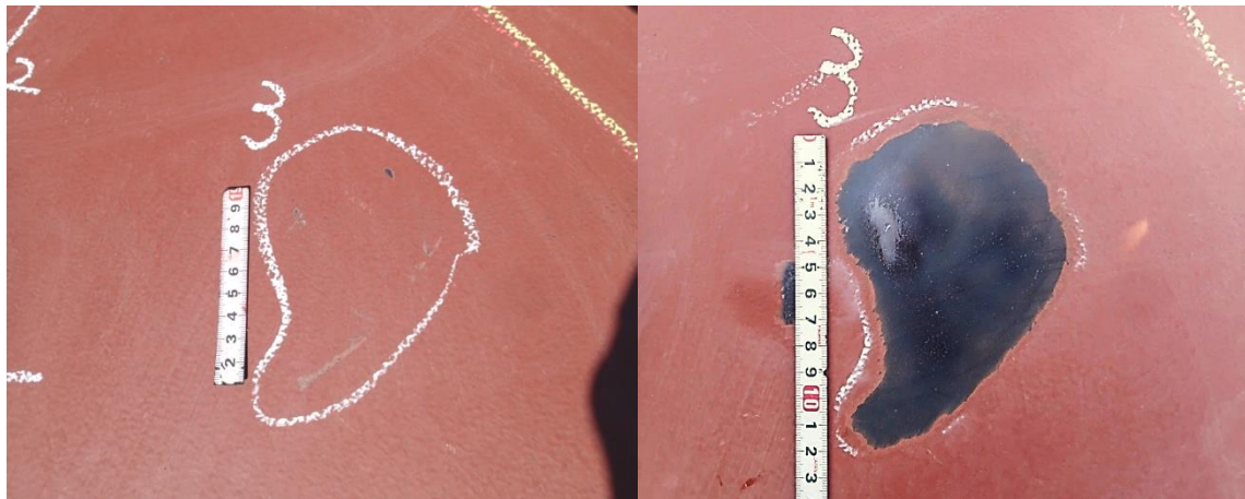
図Ⅲ2.1.1.1-20 塗装を剥離する前の損傷状況と塗装剥離後の母材損傷状況
