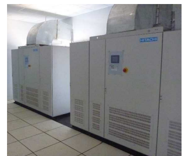
PCS設置状況
