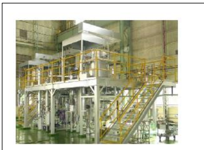
図 1-2-3-1. バイオマスガス化試験設備
