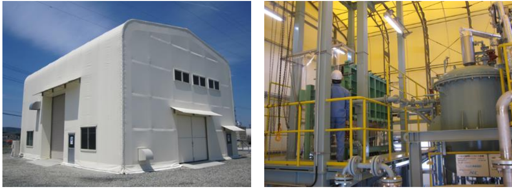
図1 大型電解装置移設後の建屋外観（左）、電解槽および周辺機器（右）
