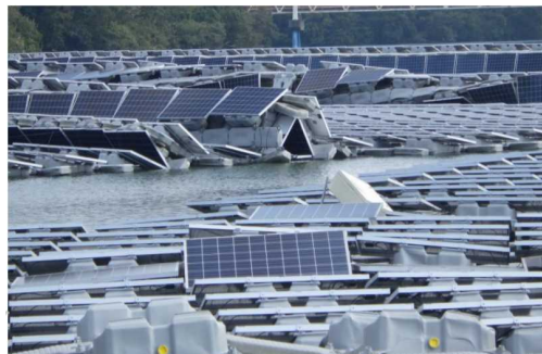
台風による被害(水上)
