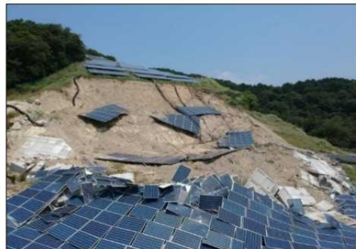
集中豪雨による土砂崩れ(傾斜地)
