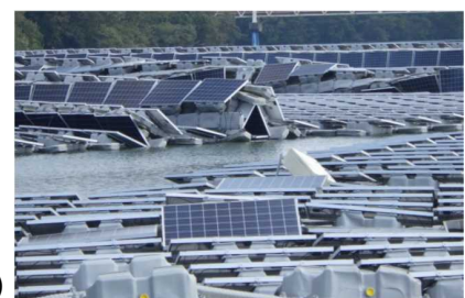
台風による被害(水上)
