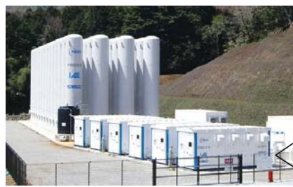
圧縮空気エネルギー貯蔵システム
