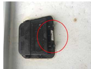
端子から導線が切断 されている様子
