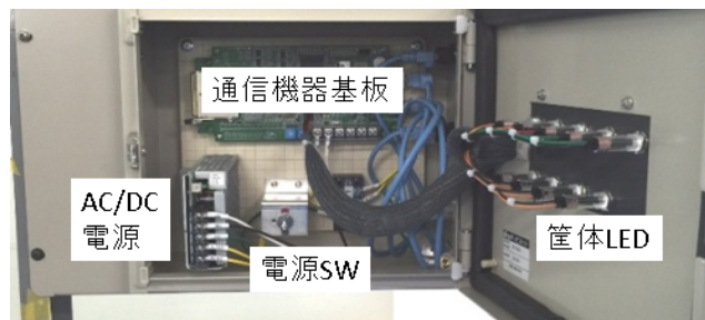
図 7.2 通信機器のシステム構成と外観
