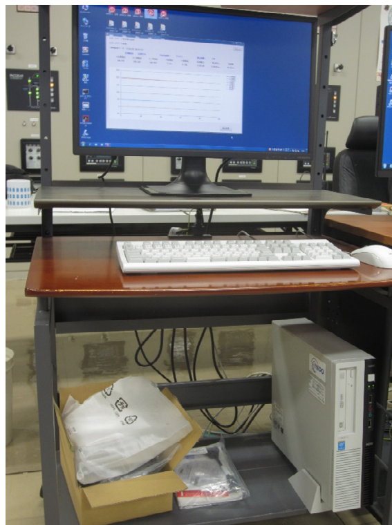
図 5.4(2)-6 PV 模擬電源装置の計測・制御システム(計測制御親局)
