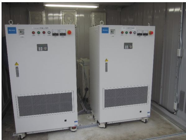
図 5.4(2)-2 100kW 級大規模 PV 模擬電源装置
