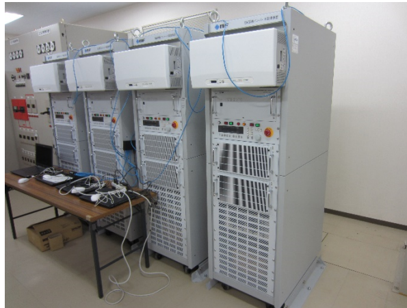
図 5.4(2)-8 低圧住宅用 PV 模擬電源装置
