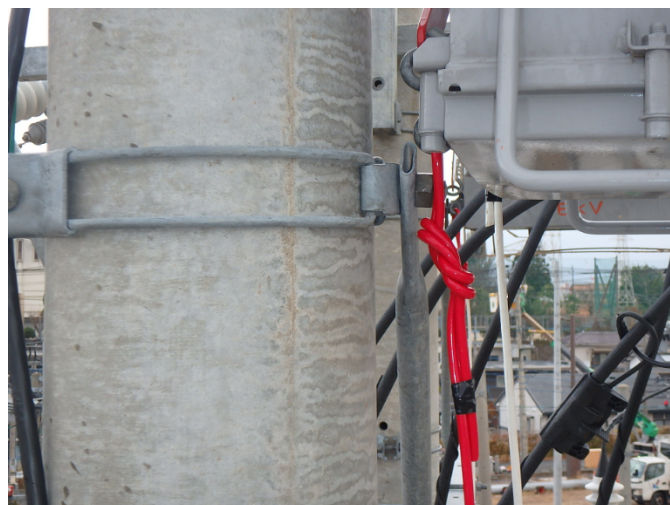
図 5.4(3)-7 開閉器操作網とアームタイバンドの干渉(上左図の矢印方向からの写真)
