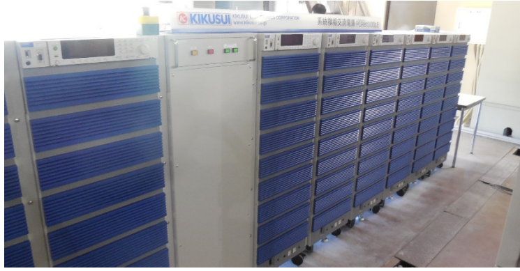
图 5.4(1)-5 高機能低圧交流電源装置
