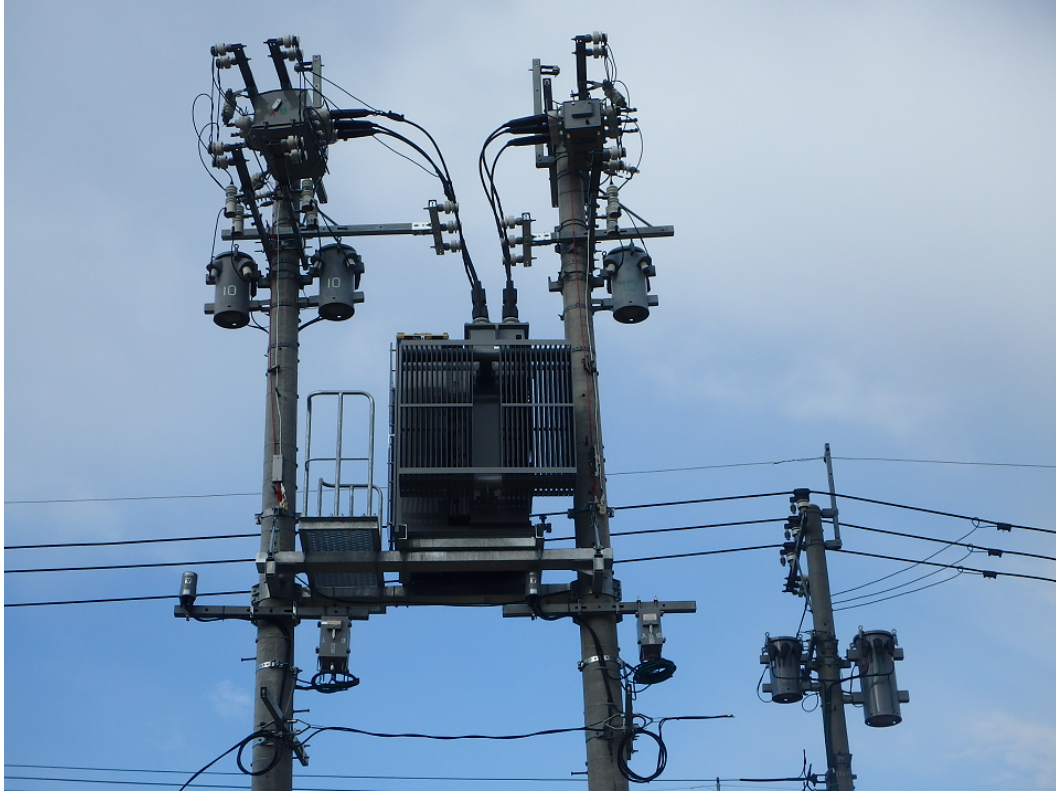
図 5.4(3)-8 次世代 TVR 設置例(遠制ケーブルあり)
