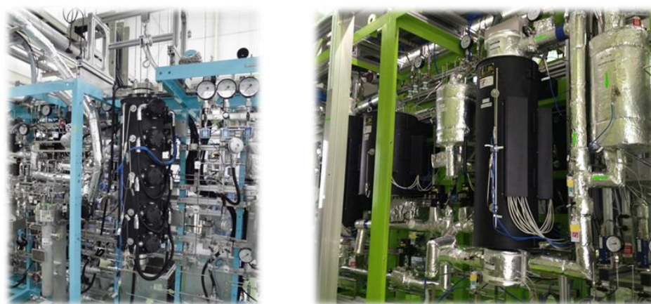
図Ⅲ.2.2.5.1-1 2016 年度に検討した小型パイロットプラントの外観 (左：メタノール合成小型パイロット、右：MTO 小型パイロット)
