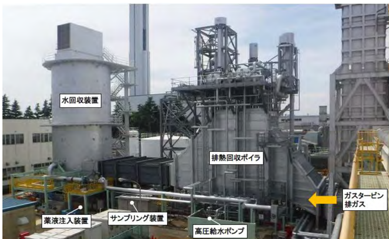
図 3. 2. 2-②-①-2 実証機のプラント全景写真（平成 29 年 7 月）
