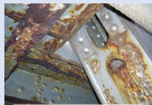
支柱のさびが進行
