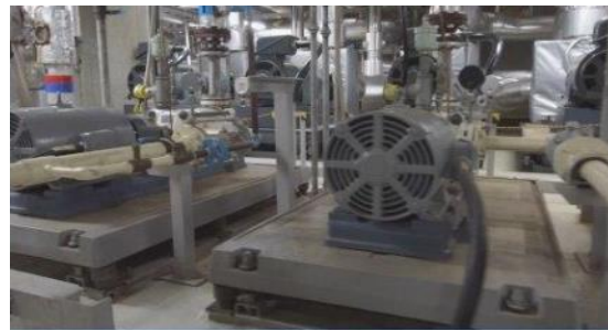
晴海アイランド地区熱供給センター
