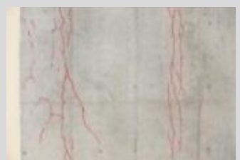
ひび割れ モニタリング
