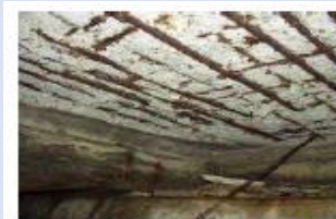
塩害により鉄筋がむき出し
