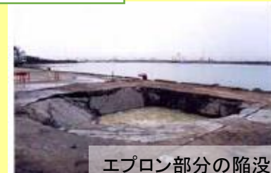
エプロン部分の陥没
