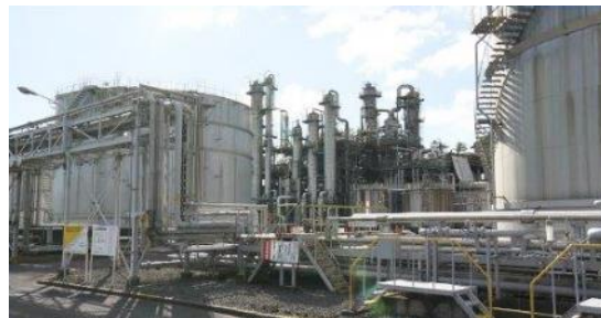
配管の腐食検出
