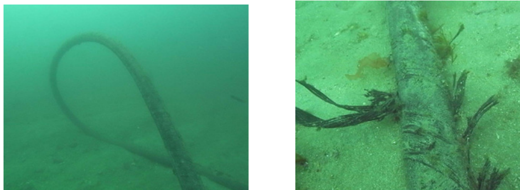
図 7.4-1 海底ケーブルの変位状況防食層の損傷状況
