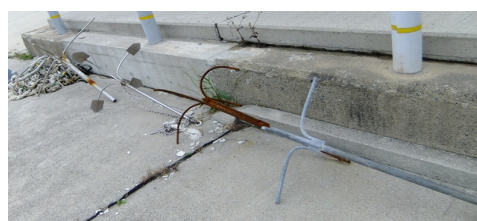
図 7.4-3 水中心検にて設備周辺で回収された放棄アンカー
