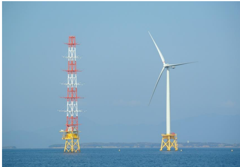
図Ⅱ.3.2-6 着床式洋上風力発電実証研究施設（北九州市沖）
