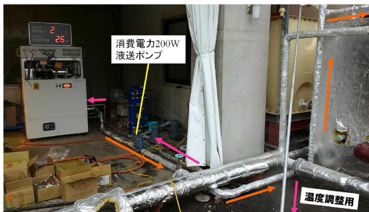
図Ⅲ(2.2)-9.小浜温泉に設置した温水発電システム
