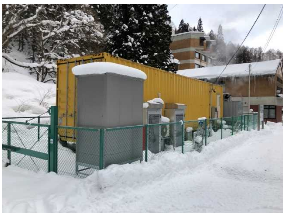
図Ⅲ(2.4)-13.実証試験設備全体
