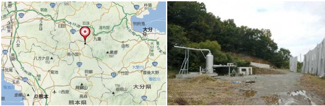
図Ⅲ(2.3)-3 熊本県小国町地熱発電設備
