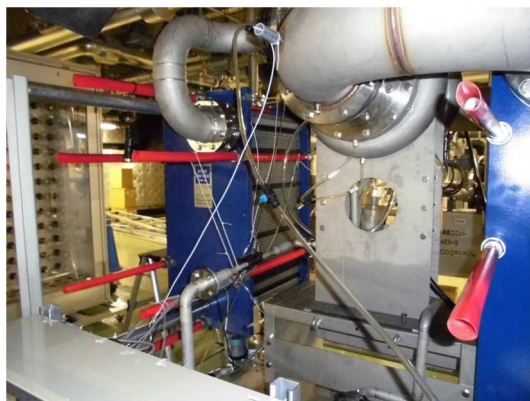
図Ⅲ(2.4)-12.TIF実証試験装置外観写真
