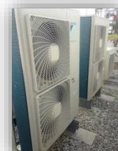
ヒートポンプ室外機
