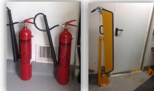
CO2ガス消火器
