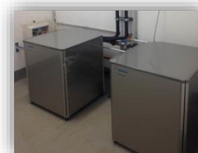
ヒートポンプ室内機
