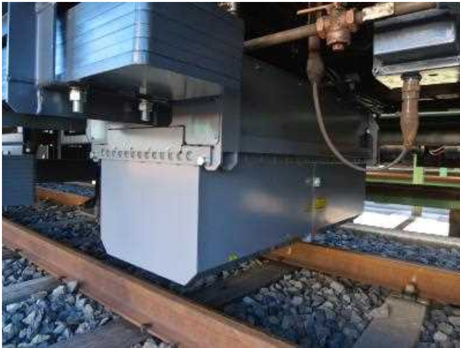
図Ⅲ-2-②-10-20 軌道変位常時監視システム
