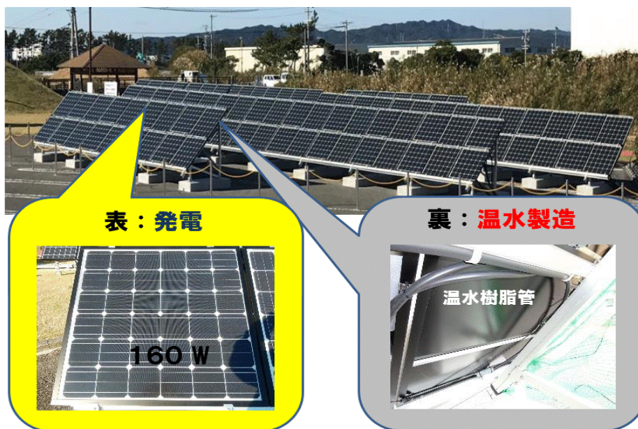
図Ⅲ-2-③-14-16 実証プラントの外観と「温水」ラインのパネル連結方法
