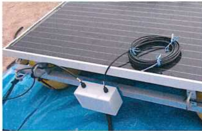
III-2-①-9-6 漏電遮断リレー取り付け写真
