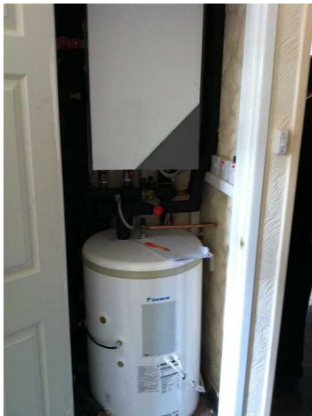
室内のタンクの様子
