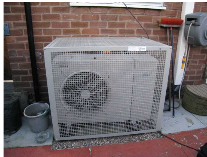
室外機の外観
