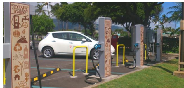
図15 急速充電ステーションの例
