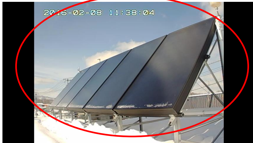
改築実証住宅（太陽熱温水パネル傾斜角 45^{\circ} ）ほぼ全面で積雪なし
