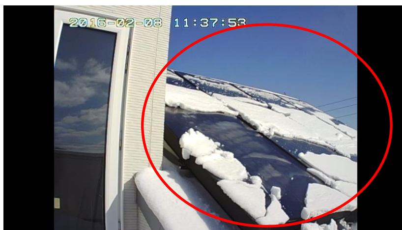
新築実証住宅（太陽熱温水パネル傾斜角 30^{\circ} ）50%程度の表面に積雪あり
