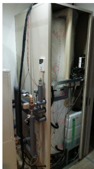
屋内設置の貯湯 460ℓタンク
