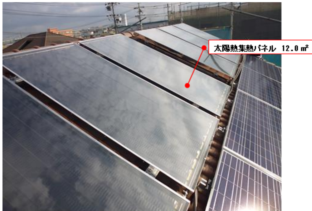
チリウヒーター社 製強制循環式集熱器 CSC2C 1,020×2,002×72 2.04㎡/台 (計6台)
