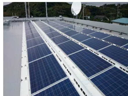
小型太陽光発電所(小学校屋上)
