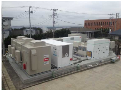
発電所内の系統用蓄電池(1,000kWh)
