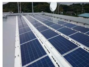
小型太陽光発電所(小学校屋上)
