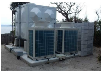
ヒートポンプ
