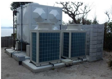
ヒートポンプ
