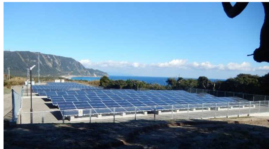
大原太陽光発電所(315kW)
