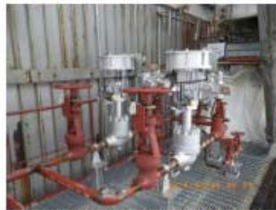
試験用蒸気流量調節弁(FL32,800)
