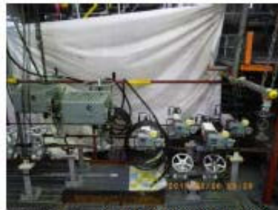
水スプレー温度調節弁(FL34,600)
