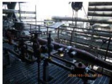
排出蒸気減温器下部(FL6,000)
