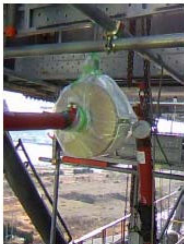
65A 配管保温と配管吊装置
