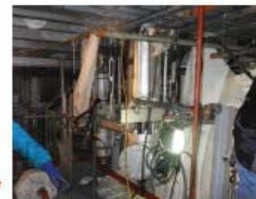
安全弁(FL29,800) (手前=東亜 V 製、後方=岡野 V 製)
