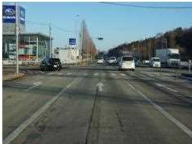
コンクリート舗装ひび割れ
