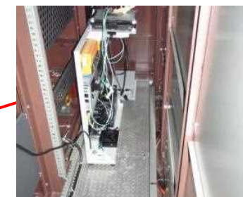
傾斜計、加速度計 PC、記録器他 (内部)
