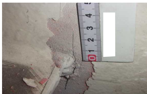
写真 ガセット端部に発生したき裂
