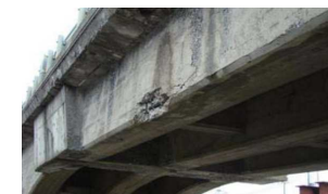
健全度Ⅲ事例：桁の断面欠損
