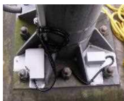
加速度計、傾斜計 (基部)
