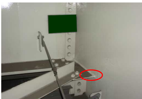
写真 鋼桁がセット取り付け部き裂位置
